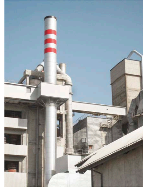
Abgaskamin am Wärmetauscher des Drehofens
